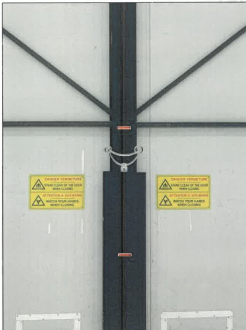
Portes des Hangars, verrouillées par un cadenas et mise en place de scellés
